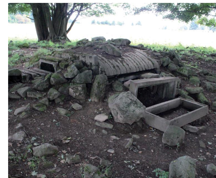
Palebný objekt na severním okraji linie je poškozen, díky čemuž je vidět jeho konstrukce. Das Geschützobjekt am nördlichen Rand der Linie ist beschädigt, weshalb seine Konstruktion sichtbar ist.
